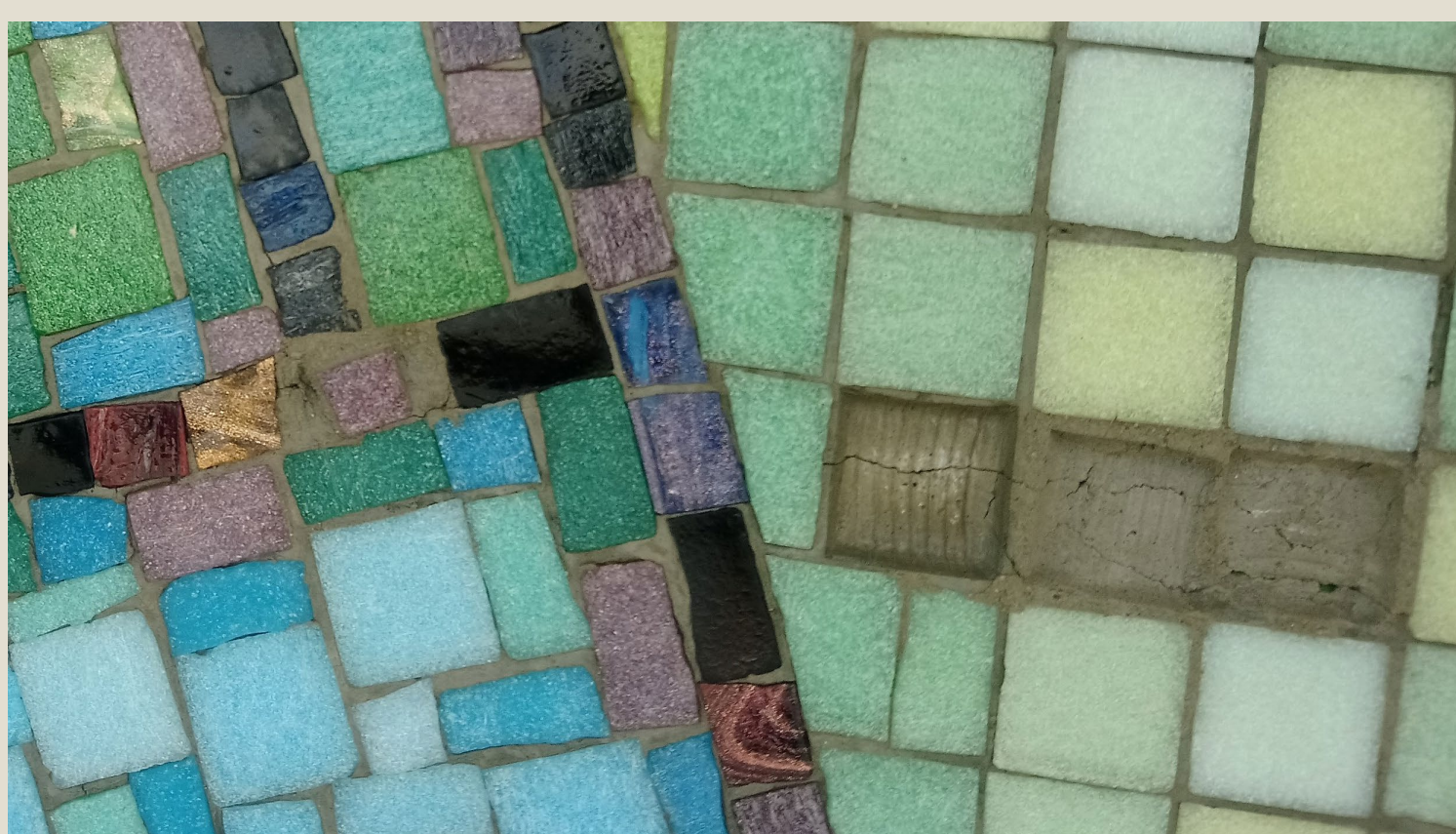
Slika 2: Poškodbe na mozaiku.
