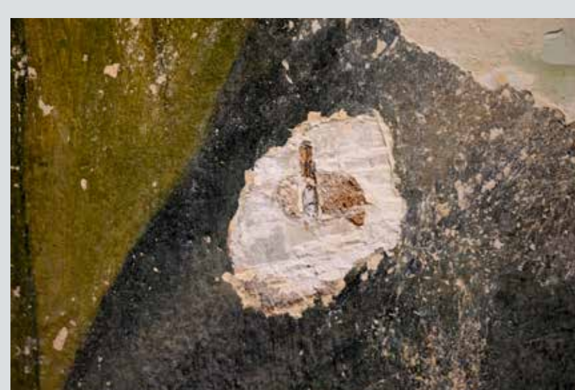
Slika 6. Poškodbe barvne plasti in ometa, dodani kovinski elementi (foto: A. Batič)
