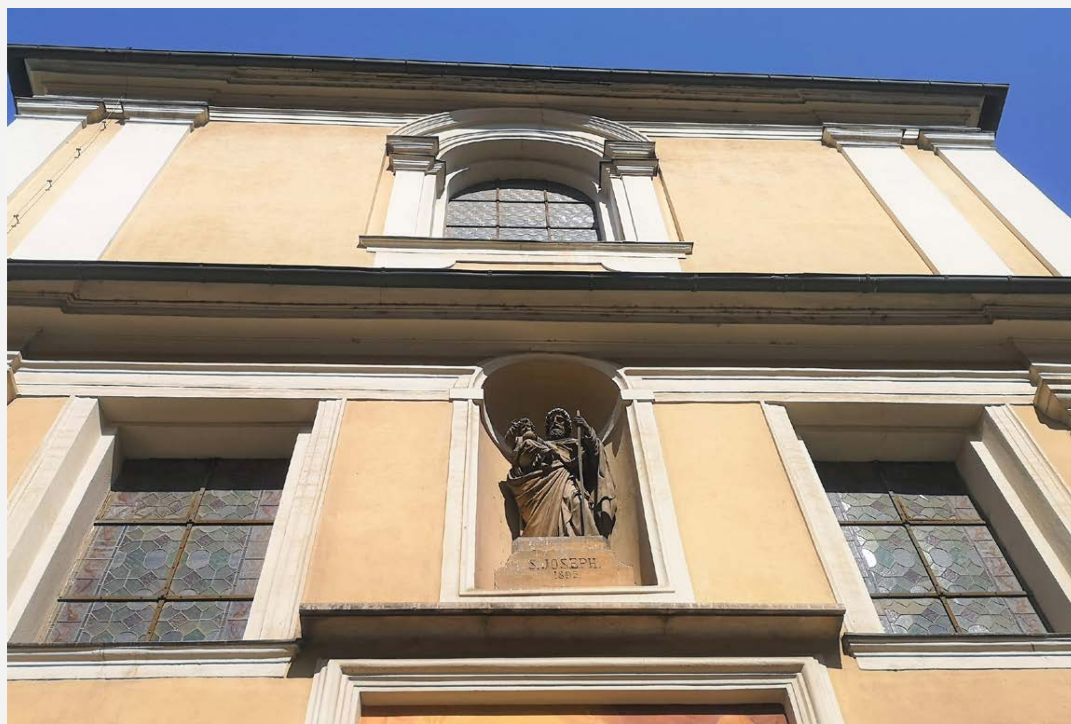
Slika 1: Južna fasada ljubljanske stolnice s kipom sv. Jožefa pred posegom. (foto: arhiv ZVKDS RC, Oddelek za kamen in štukaturo)
