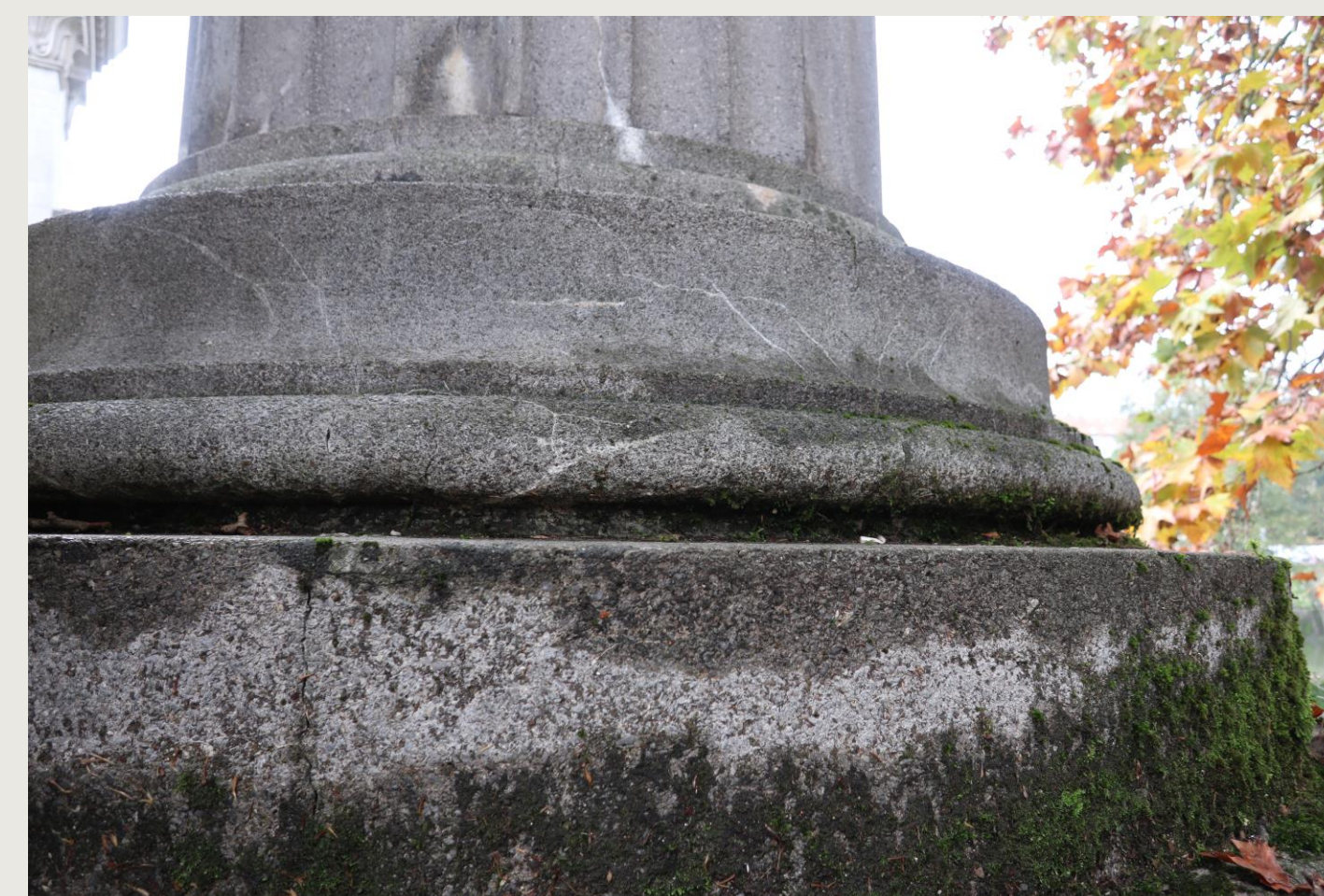
Slika 4: Biofilmi in razpoke na detajlu zapornic
