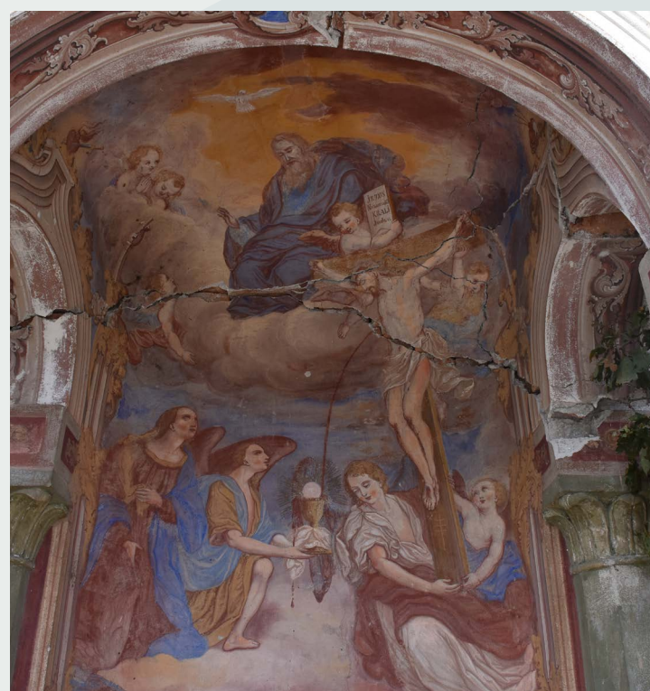
Poškodbe na kapelici nastale zaradi vetroloma.
